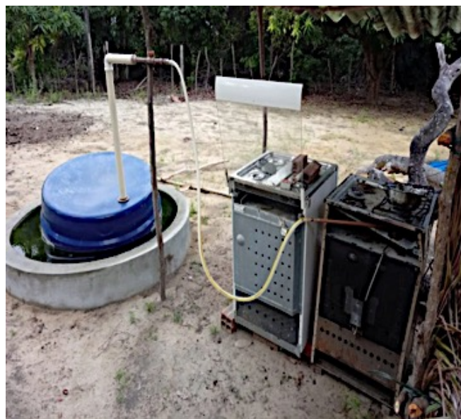
Figura 19. Biodigestor caseiro em alvenaria. (Foto: Juscelino Medeiros, 2020).
